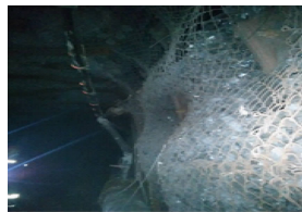
(b) 煤柱帮挤压变形
