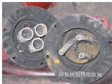
图 5 因电痕腐蚀引发故障的矿用电缆接头
